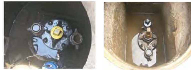
消火栓(工水) 名古屋市内に設置
