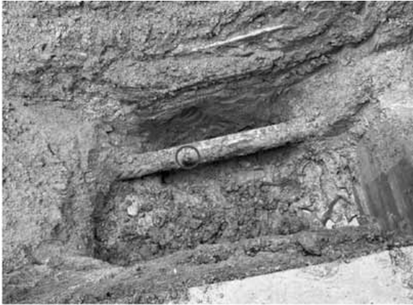
図2 漏水箇所（漏水孔1cm程度）
